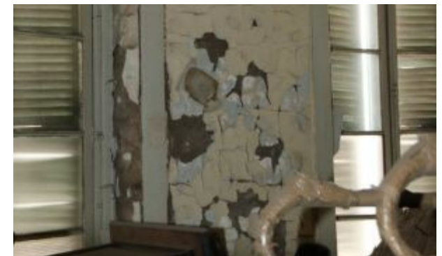
Rehabilitación de cubierta y bajada de agua (pérdida de material y corrosión en armadura metálica por humedad).
