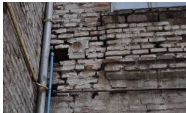
Reconstrucción de muros completos en segundo piso (desaplomados, con riesgo de colapso).
