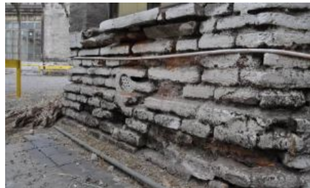
Reconstitución del mortero de pega (seriamente deteriorado y se puede remover sin herramientas)
